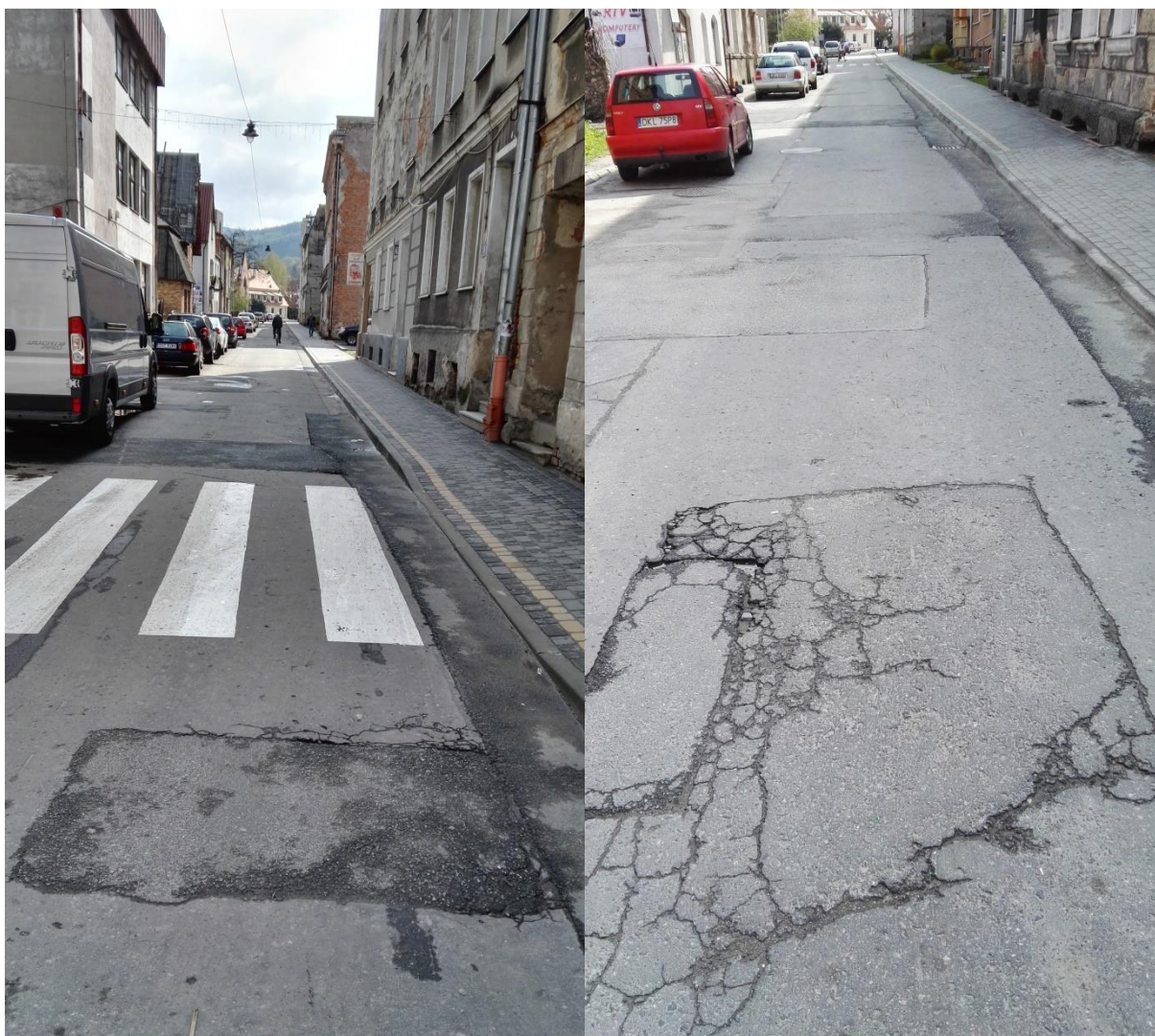
Fotografie: ul. Zdrojowa wymagająca pilnego remontu
