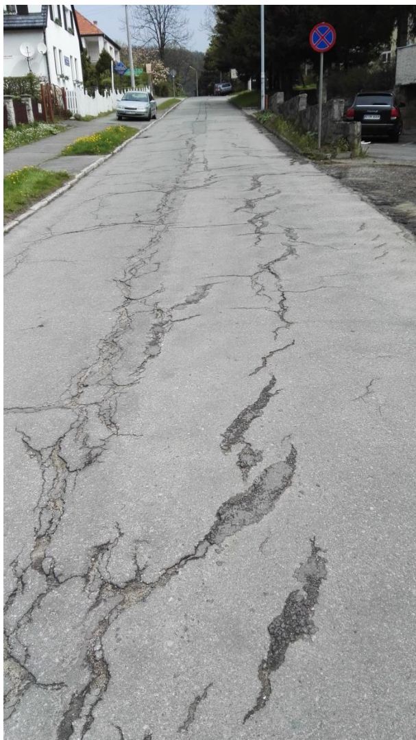
Fotografia: spękana nawierzchnia ulicy Wolności
