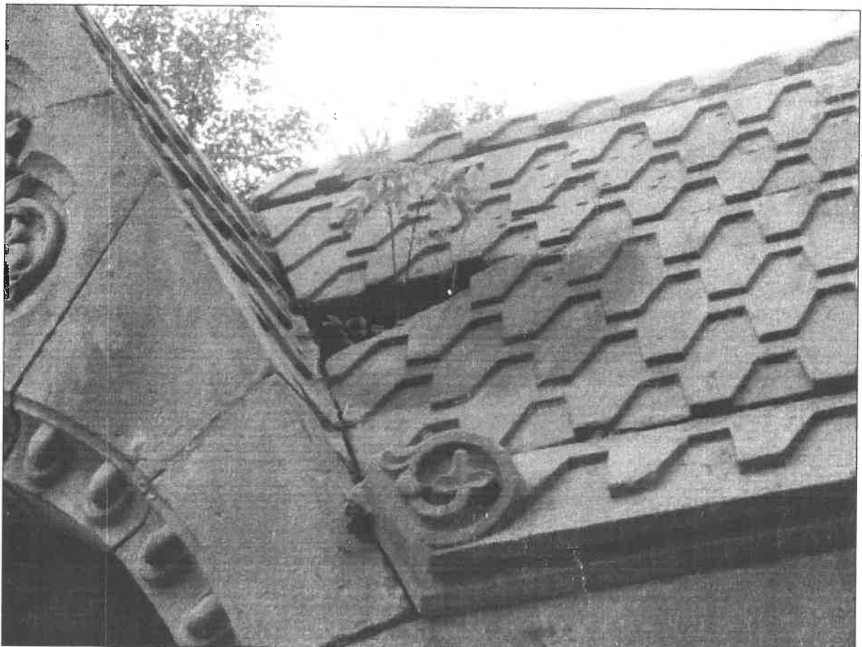
Uszkodzony dach kaplicy von Schutterów
